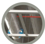
Ventilation et climatisation
